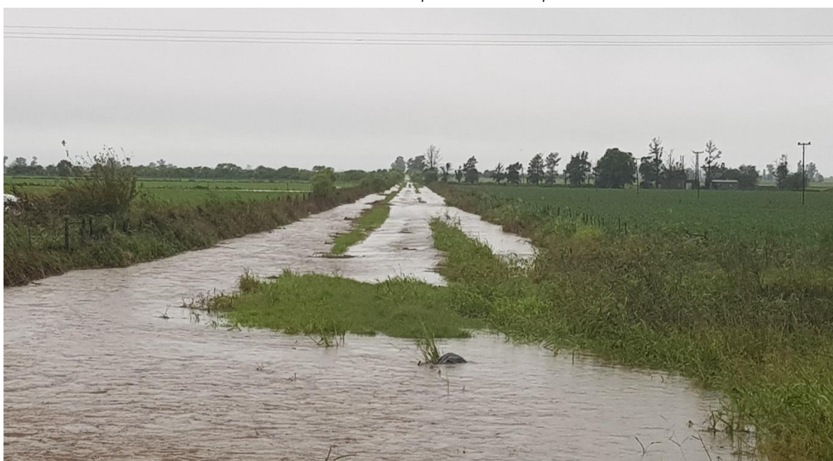
♦ Vía de comunicación de tierra, totalmente anegada e inundada, sin mantenimiento, ni conservación, en el centro del departamento Castellanos.
